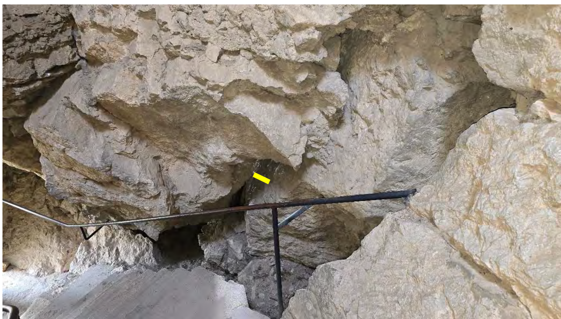
Obrázek 45: pohled na vnitřní strukturu masivu, vyznačena puklina, která před 30 lety byla do 5 mm, strukturní dlouhodobý pohyb bloků masivu je již hraniční, puklina vyznačena
