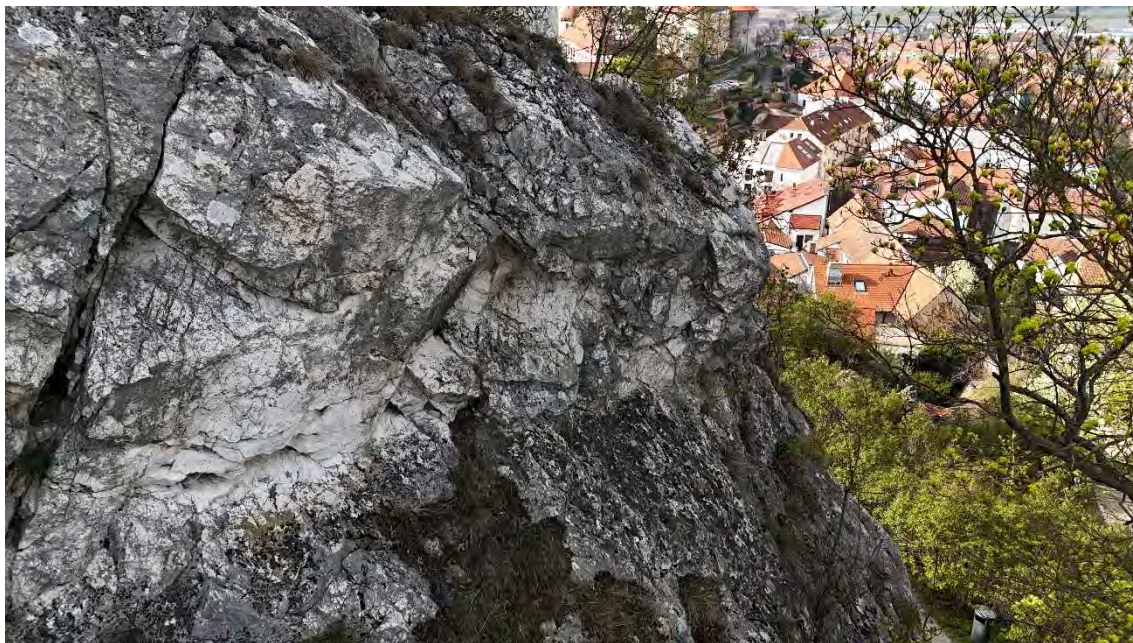
Obrázek 13: pohled na převíslé části masivu s výrazným rozevřením puklinového systému masivu 5 – 75 mm
