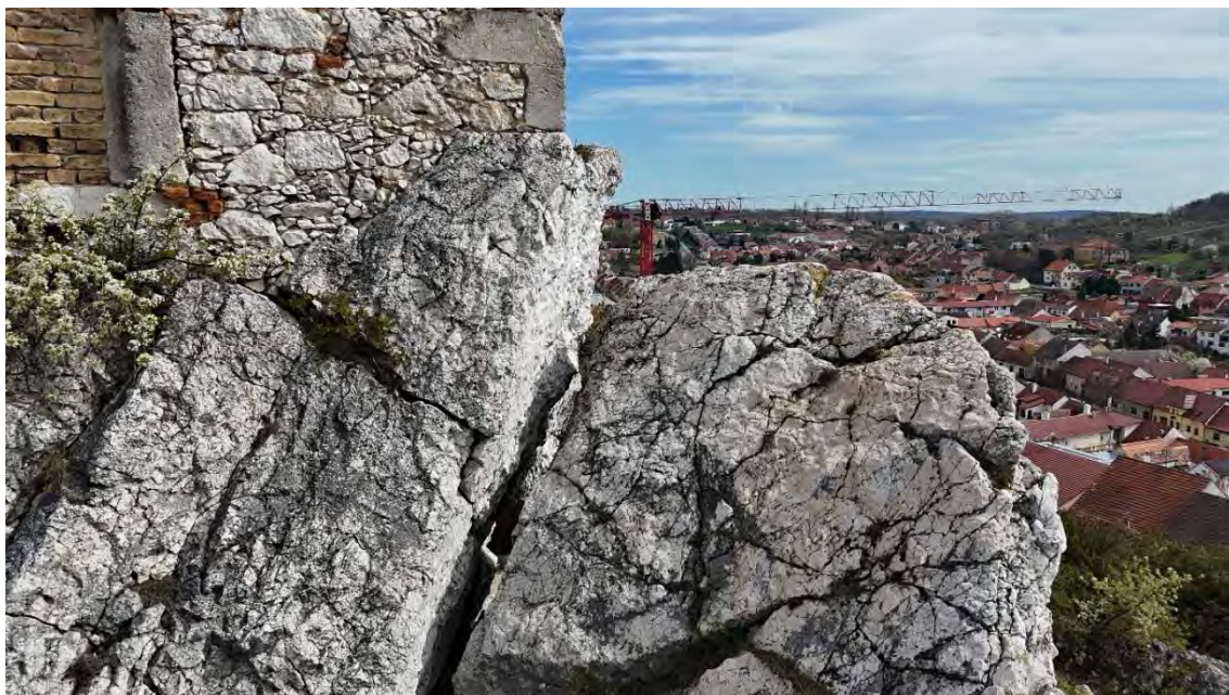
Obrázek 31: detail oddělující pukliny masivu, na kterém stojí věž a bloku břitu, je zřejmé i sekundární zvětrání masivu a systém poruch všesměrným uspořádáním
