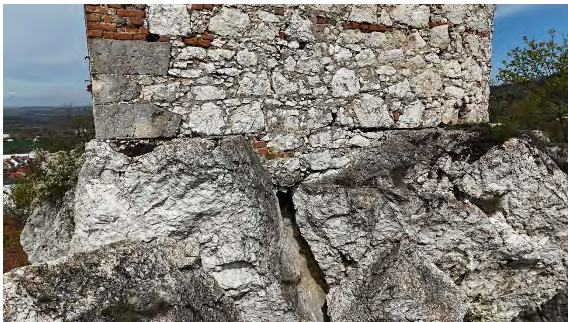
Obrázek 49: detail stavu zdiva východní stěny věže ve vazbě na skalní masiv a jeho poruchy, u zdiva jsou zřetelné stopy po přechozích opravách zdiva po jeho narušení vlivem pohybem bloků a zvětrání masivu
