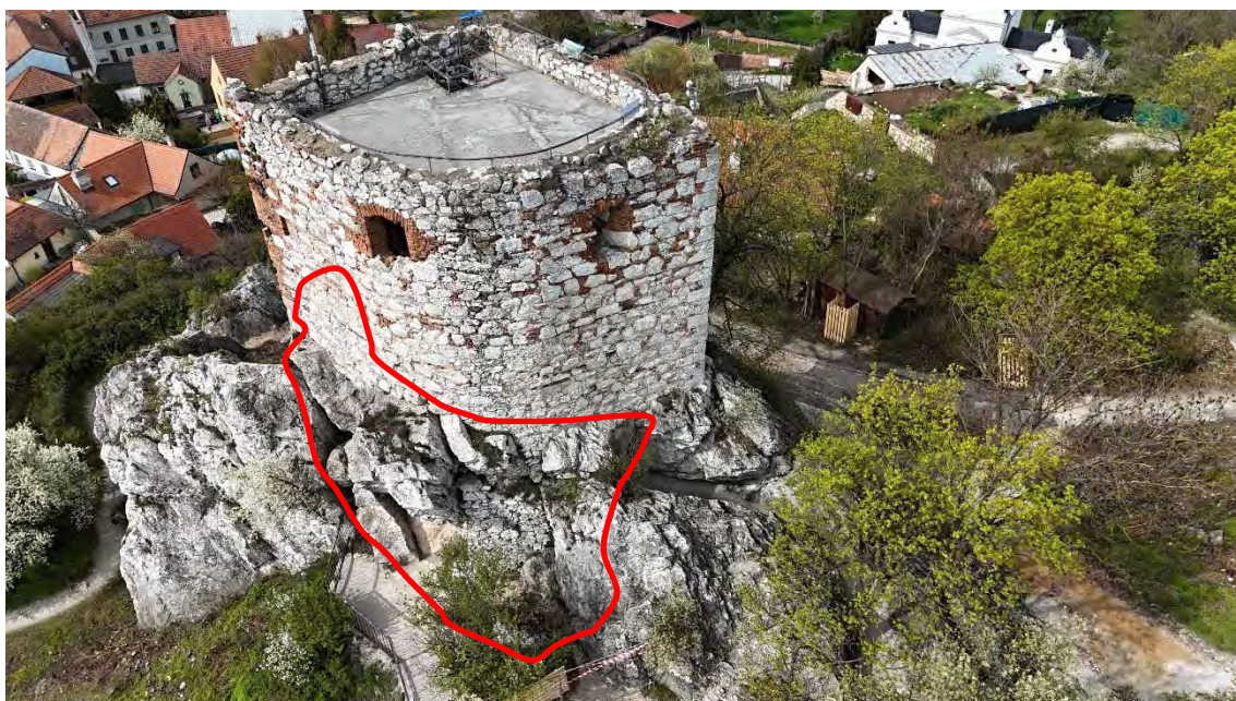
Obrázek 48: horní pohled na objekt věže Kozího hrádku s vyznačenou zónou nestabilních partií masivu a narušené obvodové zdi
