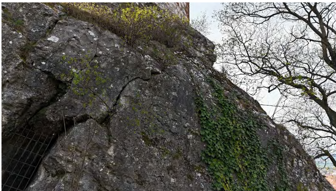
Obrázek 15: pohled na stěnu masivu sektoru SEVER, chráněný vstup do podzemí objektu, vstup se nachází v narušeném masivu s rozevřeným systémem puklin, který umožňuje infiltraci srážkové vody do nitra masivu
