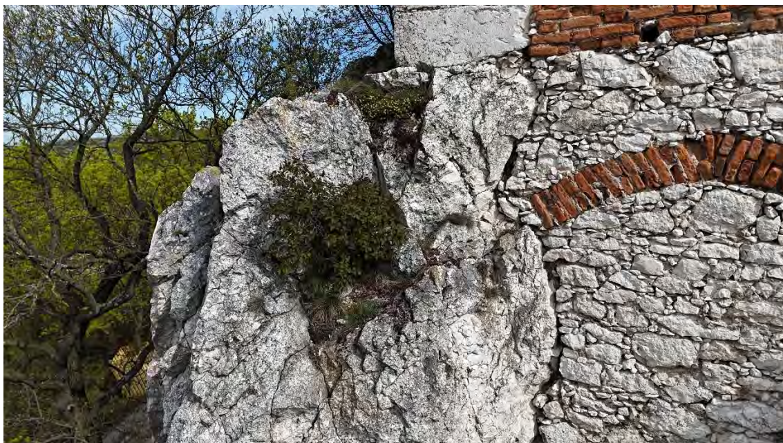
Obrázek 21: detail levé horní partie sektoru s vazbou na vyzdívku masivu s patrným rozvíráním průběžné spáry díky strukturním změnám masivu
