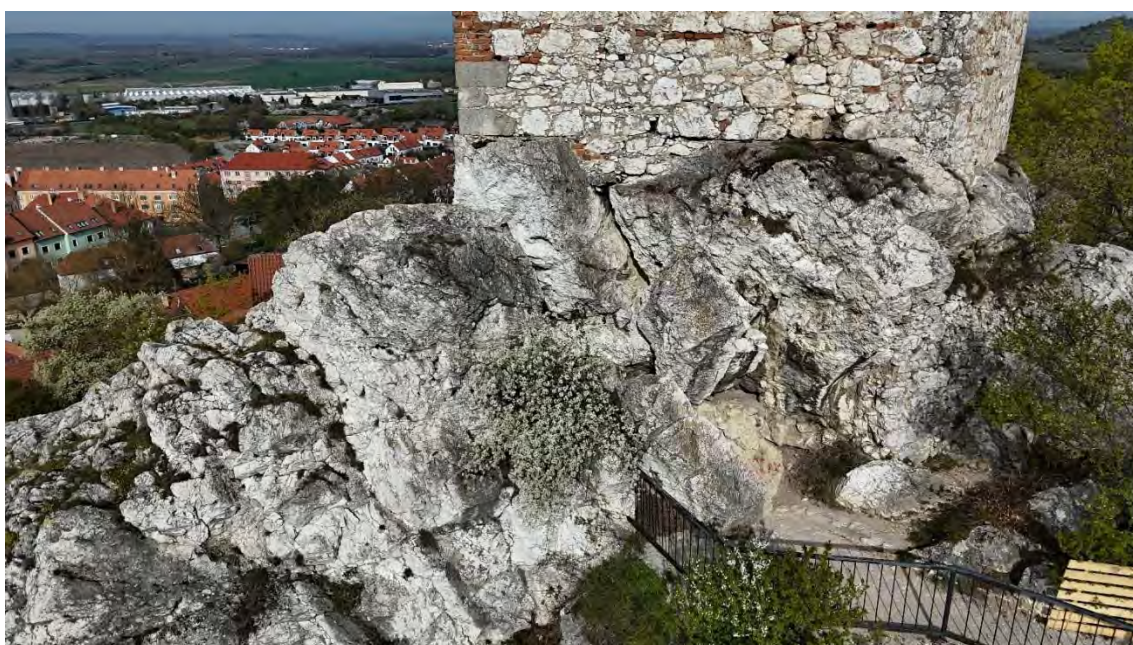
Obrázek 36: východní strana sektoru VĚŽ s nejvíce narušeným masivem, kde jsou dokumentovány největší strukturní změny
