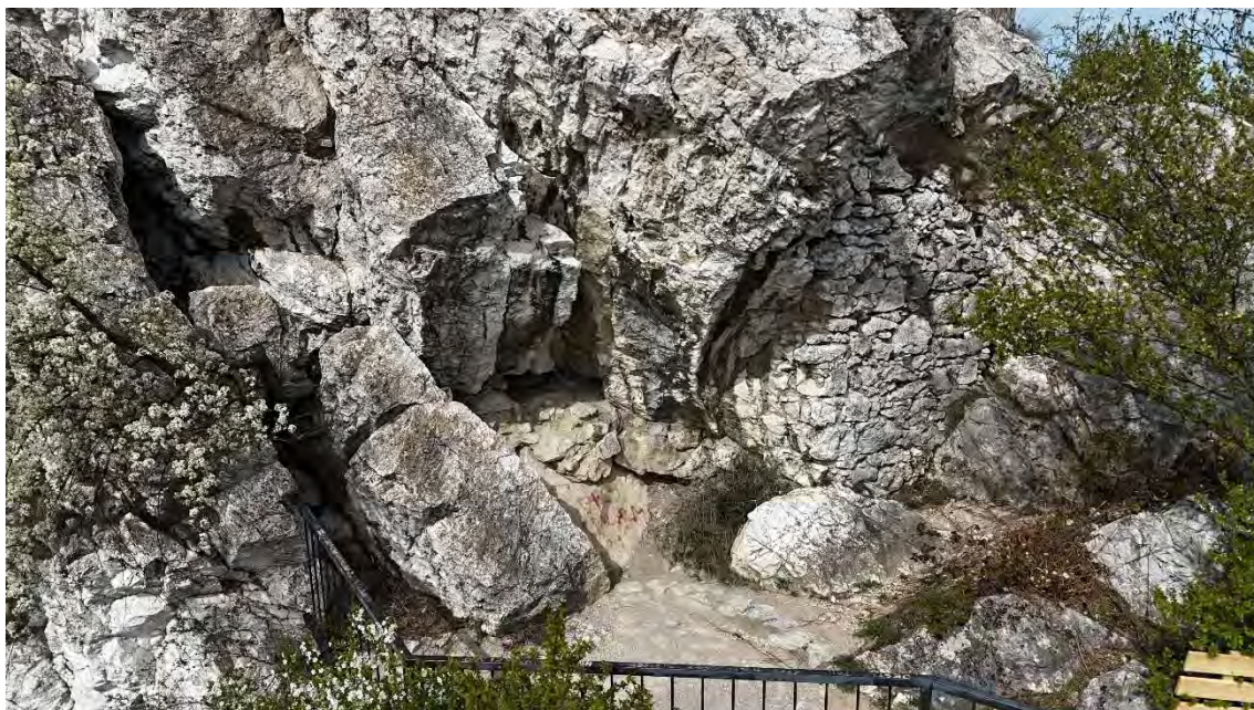
Obrázek 47: celkový pohled na stav spodní části východní stěny masivu sektoru VĚŽ se staršími vyzdívkami mezi bloky, bloky jsou stále v pomalém pohybu
