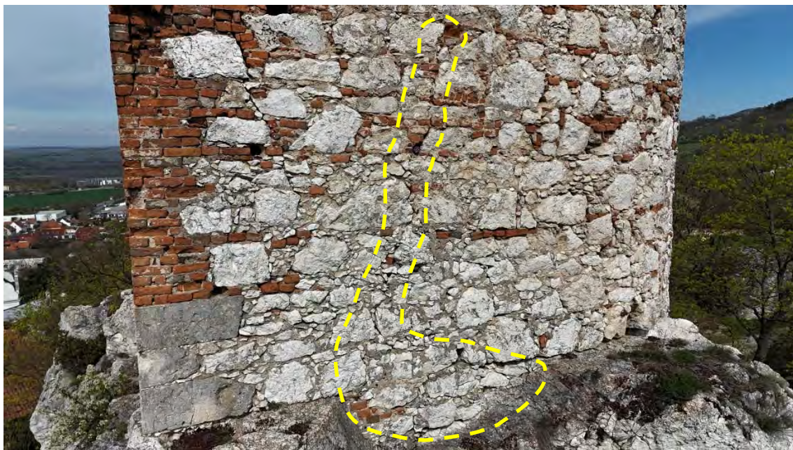
Obrázek 37: detail zdiva východní stěny objektu věže s vyznačenou linií trhliny zdiva, která je vázána na níže položené strukturní poruchy masivu a rozvírání puklinového systému
