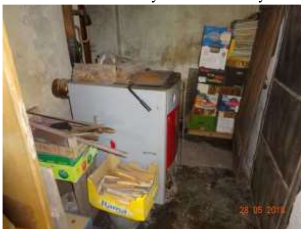
Pohled do kotelny v 1. PP
