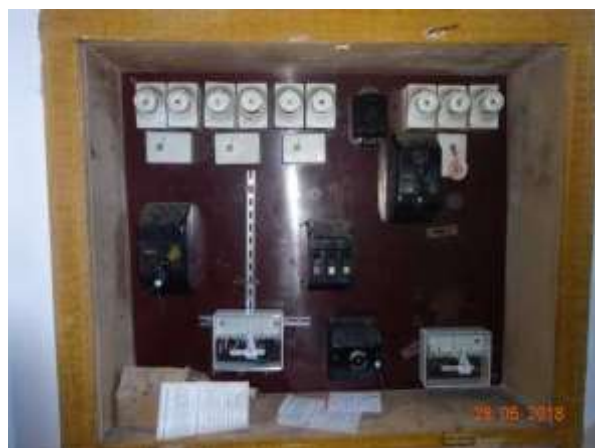
Pohled na el. rozvaděč
