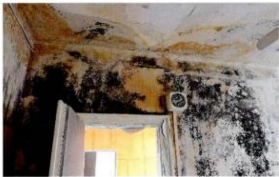
zatékání ze střechy
