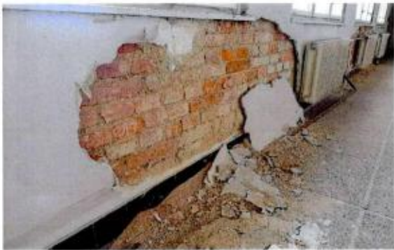
odmrzlá omítka v chodbách
