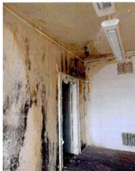
zatékání ze střechy
