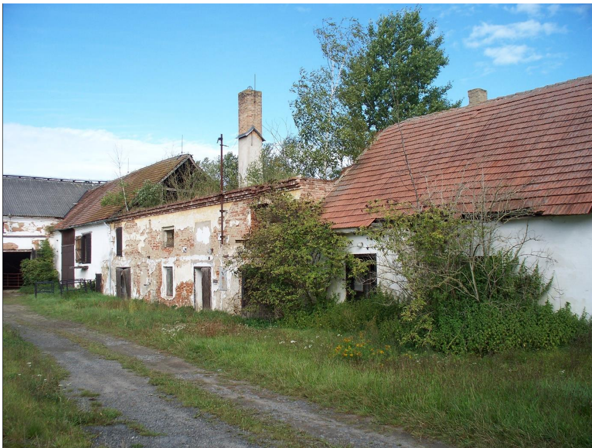
7. Pohled ze dvora na nevyužívaná stavení za vjezdem po pravé straně
