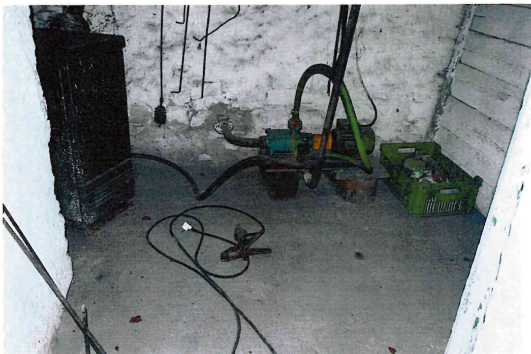
Sklep s kotlem ústředního topení
